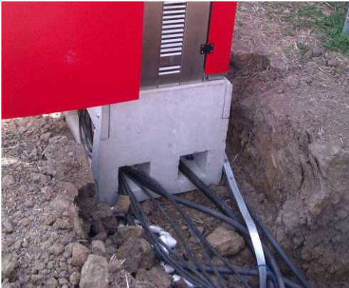
Bild 1: Aufstellung mit Betonsockel
