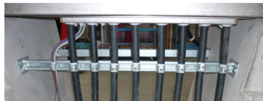
Bild 30: Befestigung der Kabel an C-Schiene
