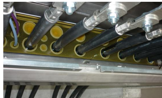
Bild 33: Mit Kabelharz abgedichtete Leitungen
