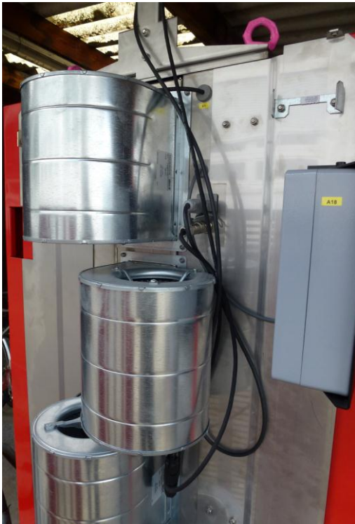
Bild 81: Kabelführung um Lüfter
